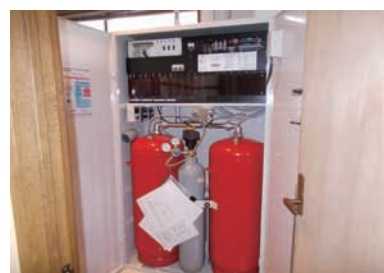
パッケージ型自動消火設備
